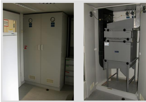
Filterschrank für Abluftfilter
